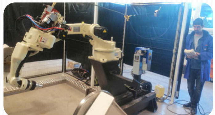
3. kép: Helyszíni telepítés
